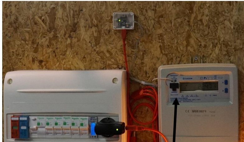
Sensor aplicado no contador
